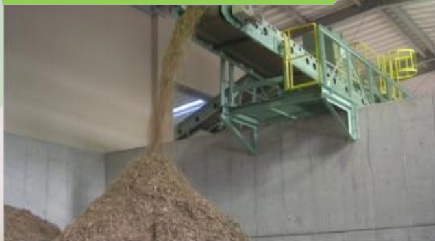
バイオマス発電燃料製造 産業廃棄物の適正処理
